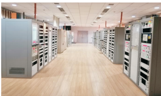
图 9 改造完成之后的短波发播机房
